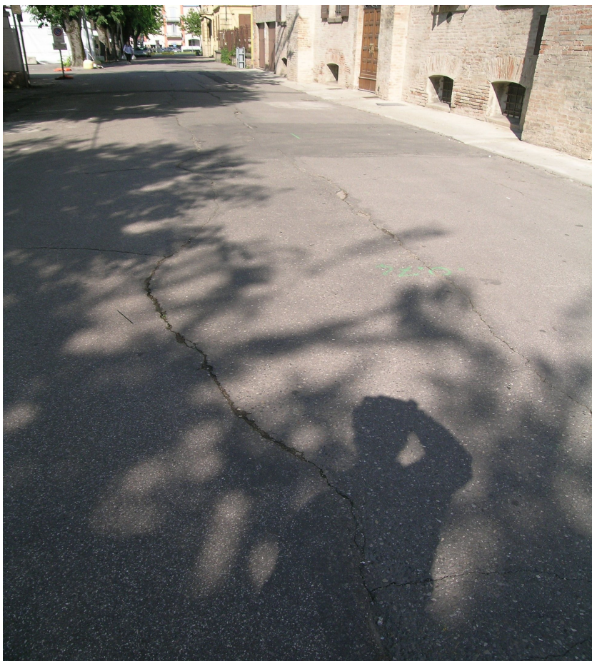
Illustrazione 15: Piazza Castello vista da Est verso Ovest: il secondo dei rami della linea transiterà qui: si noti la presenza, sul pavimento stradale, di vari rappezzi corrispondenti ad altrettanti interventi di scavo recenti.
