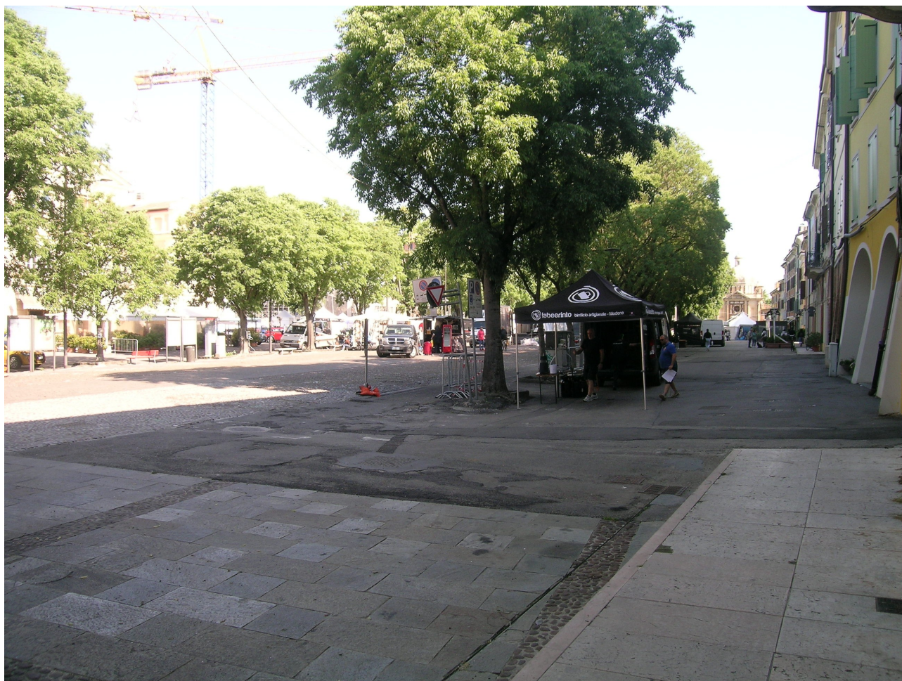
Illustrazione 16: Il lato Est di Piazza Costituente visto da Sud verso Nord, sede del terzo tratto della linea in progetto: anche qui sono evidenti i rappezzì nella pavimentazione stradale che indicano vari interventi di scavo e richiusura.
