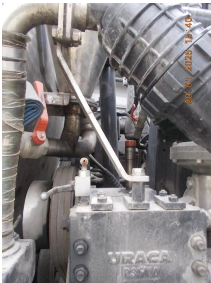
buono stato delle parti meccaniche dell'allestimento
