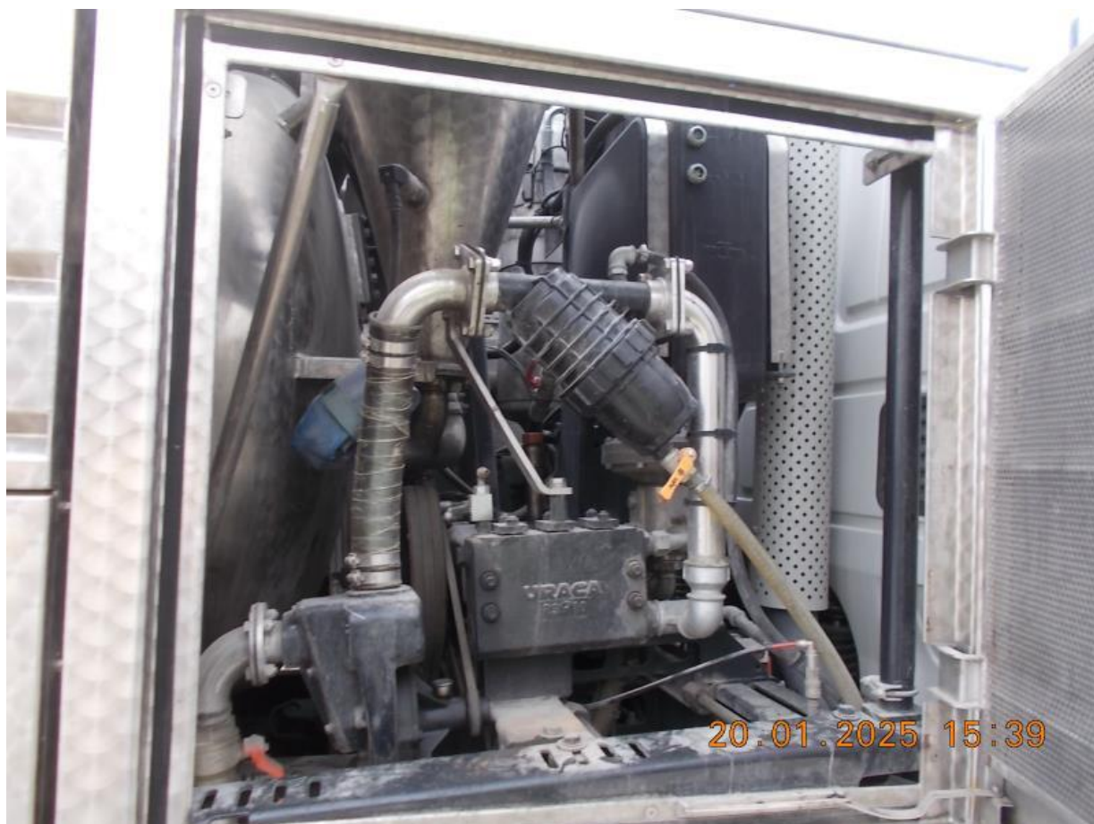
gruppo motore di servizio aalla cisterna
